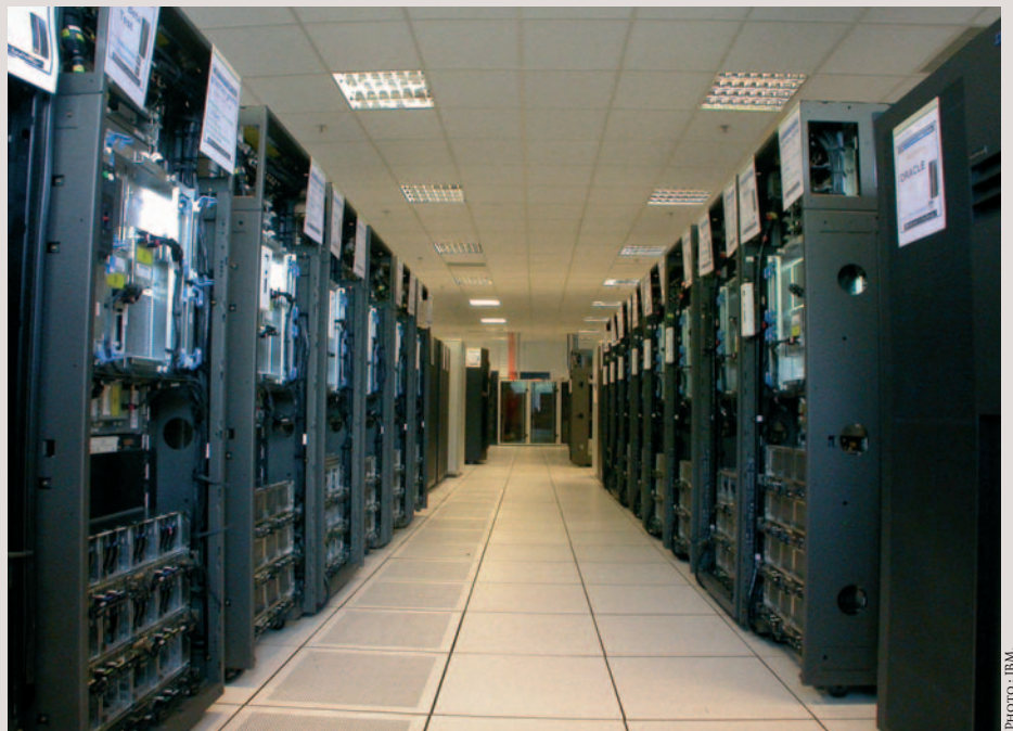
L'un des centres d'IBM baptisés "Deep Computing Capacity on Demand" (DCCOD). Ces fermes de serveurs vendent des MIPS ou des processeurs/heure avec une grande souplesse.
